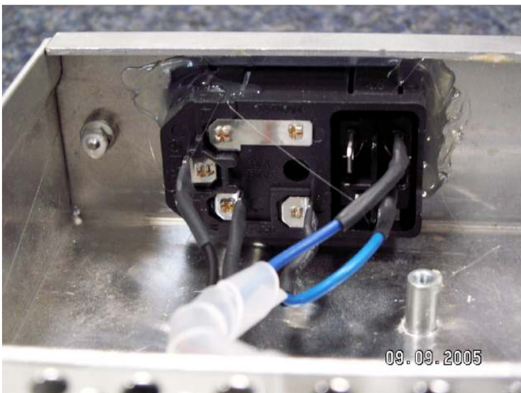
Фото 2.5. Приборная электророзетка зафиксирована с помощью клея (!!!).
